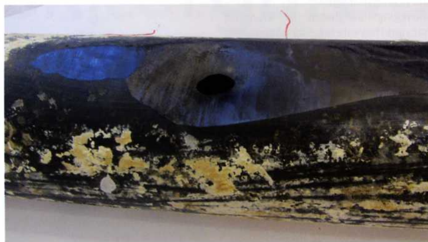
Hovedvannledning til Jomfruland som har blitt gnagd hull på. En ser i begynnelsen ofte bare en svak økning av vannforbruket før en større lekkasje blir oppdaget etter hvert. Foto: Aslaug Koksvik
